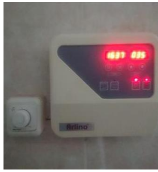
Sauna kontrol paneli
